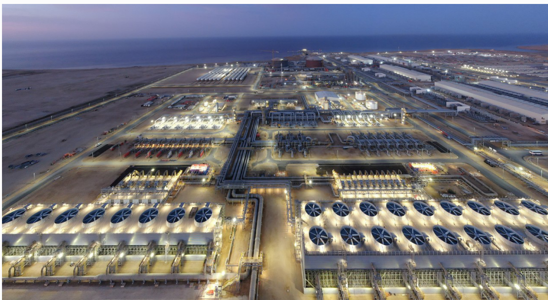
空气化工产品公司位于沙特阿拉伯新未来城（Neom）的绿氢项目公用工程区即将竣工。图片来源：空气化工产品公司
